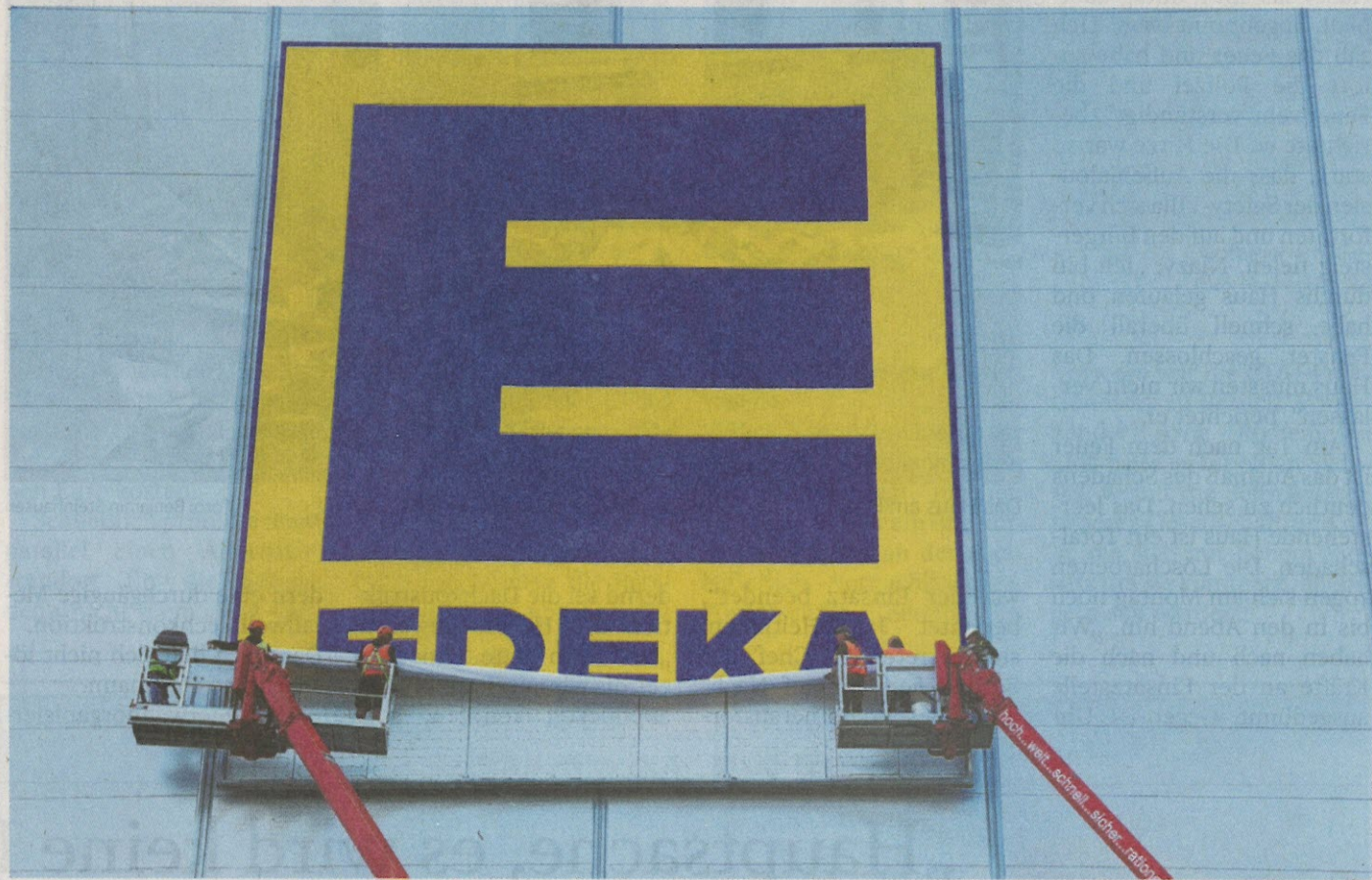
Wenige Meter noch, dann ist es getan: Facharbeiter brachten jetzt das 155 Quadratmeter große Edeka-Logo am neuen Lager des Unternehmens im Gewerbegebiet Eichhof an. Es soll bundesweit die größte innenbeleuchtete Außenwerbung sein.
