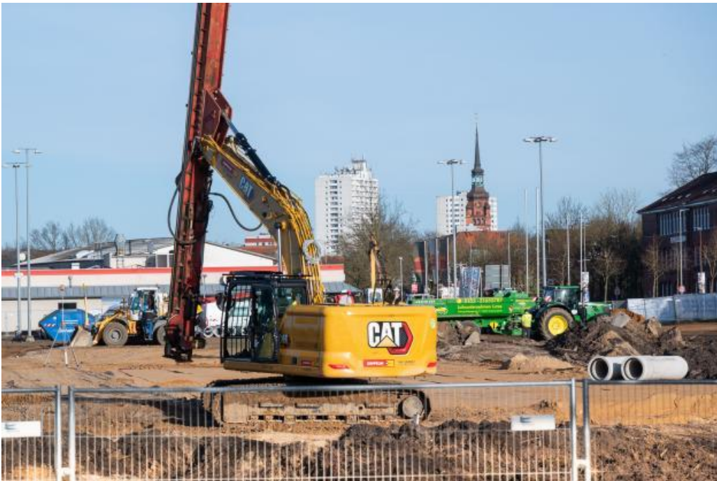
Die Maschinen stehen bereit. Baubeginn für den neuen Famila-Markt an alter Stelle in Itzehoe. Foto: Michael Ruff
